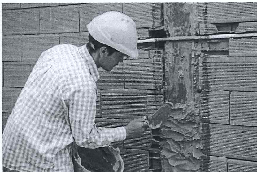
Aplicación de promotor de adherencia y revoque termoaislante sobre estructura de H°A°.
